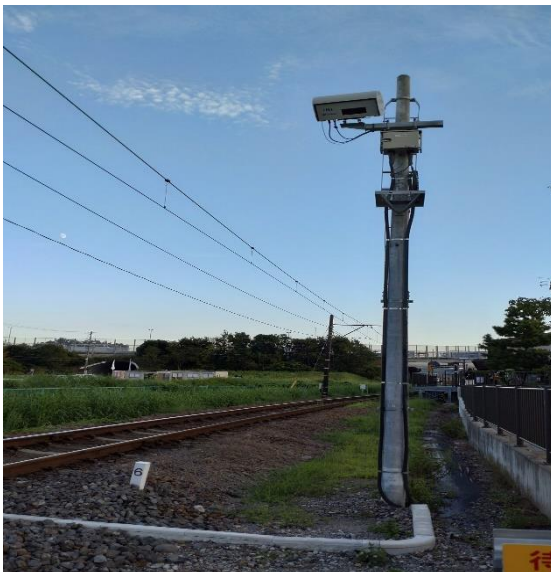
踏切障害物検知装置
