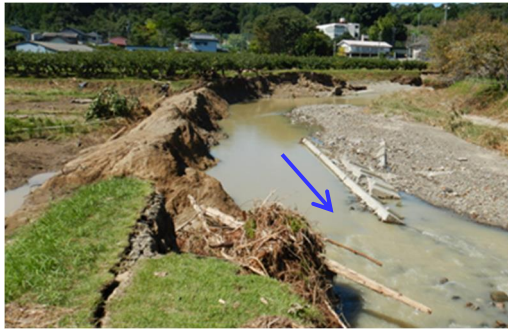
二級河川敷地川の破堤 (磐田市敷地)
