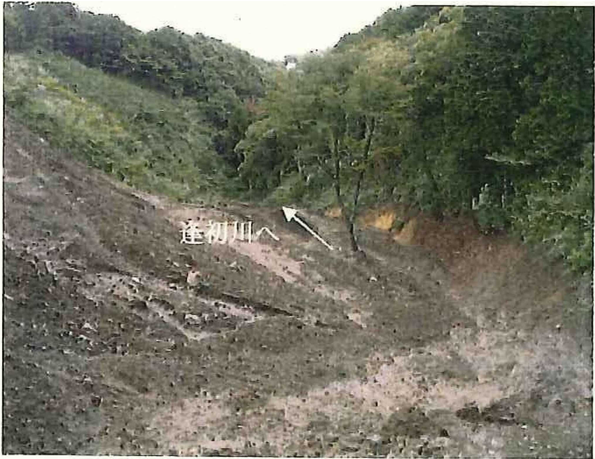
【逢初川源頭部の状況】
