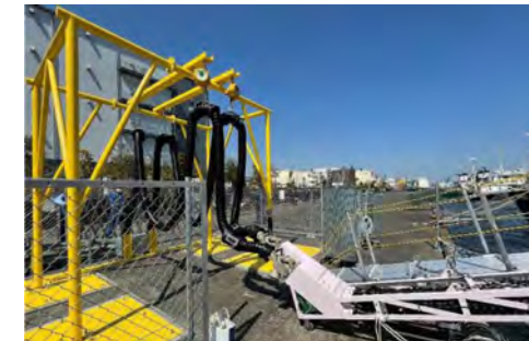
給電設備(川崎港)
