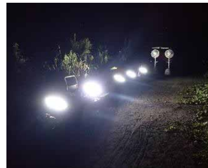
照明機器の設置状況
