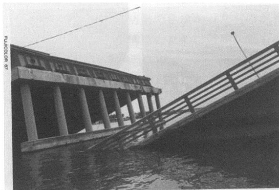
図 8-30 地盤の流動化による下部構造の大変位と単純桁の落橋（落橋防止装置未整備）
