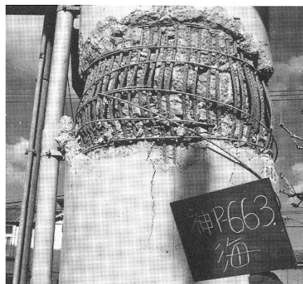
図 8-3 段落し部の曲げせん断損傷
