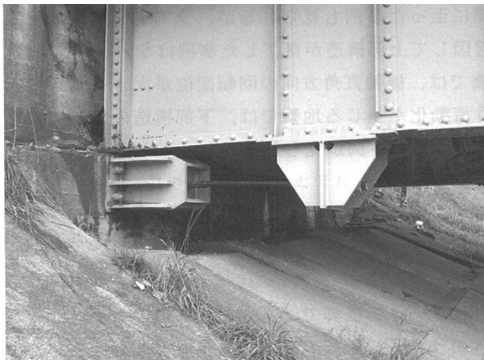
図 8-37 平成 15 年宮城県北部地震において落橋防止構造による変位拘束効果が検証された事例
