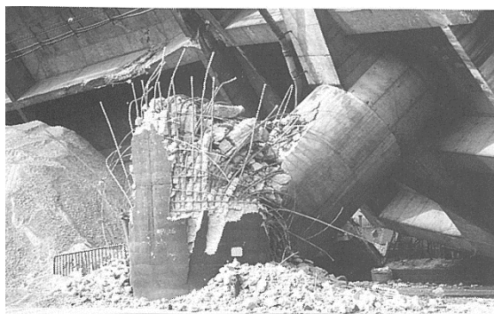
図 8-2 段落し部の損傷による倒壊
