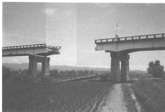
図 8-27 ゲルバー橋吊桁の落下
