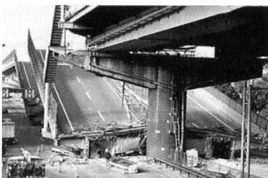
(c) シナリオ C：桁が橋軸方向へ変位した例
