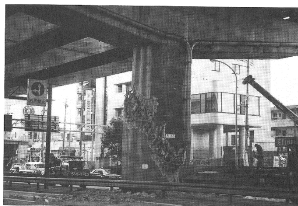
図 8-4 段落し部を起点とするせん断破壊
