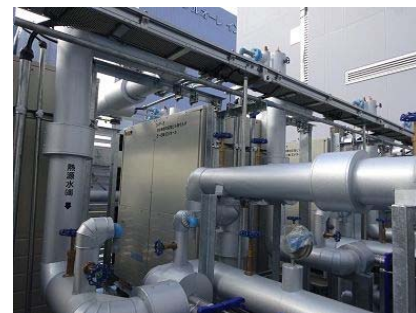
地下水熱交換システム
