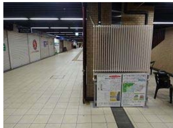
輻射型冷暖房パネル側
