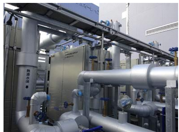
熱交換器設置状況
