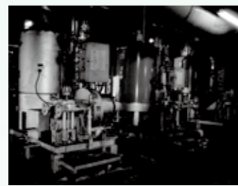
A重油貫流ボイラー
