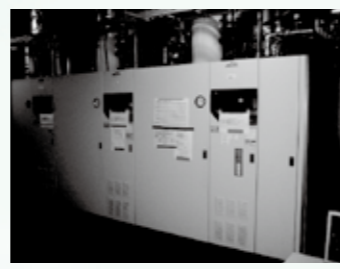
都市ガス貫流ボイラー
