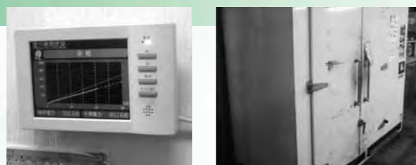
<デマンド監視装置> <乾燥機>
