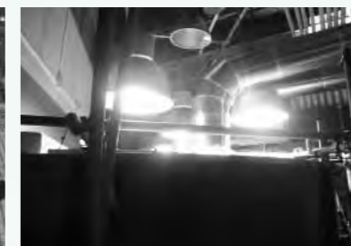
<太陽光照明内部>
