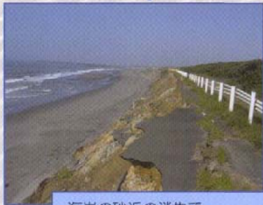
海岸の砂浜の消失で、自転車道が被害を受けた
