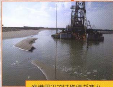
漁港周辺では堆積が進み、航路浚渫の費用が増大
